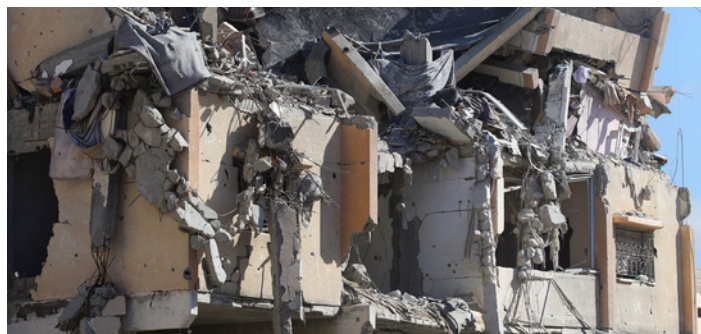
Circa il 69% degli edifici di Gaza è stato distrutto o danneggiato.
